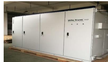
2MW 설비 사진
