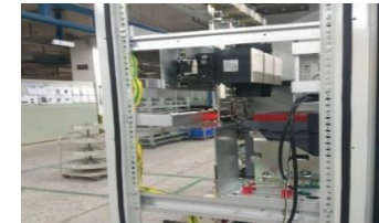
3MW 설비 사진
